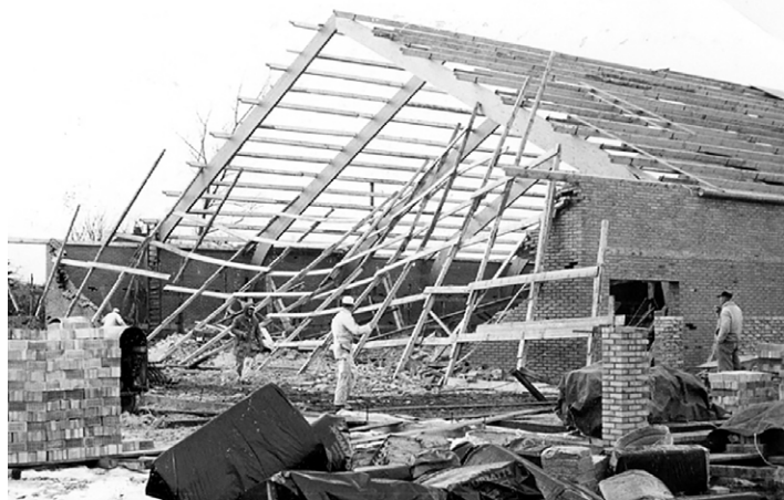
Gavlen blæste ned i en storm.
